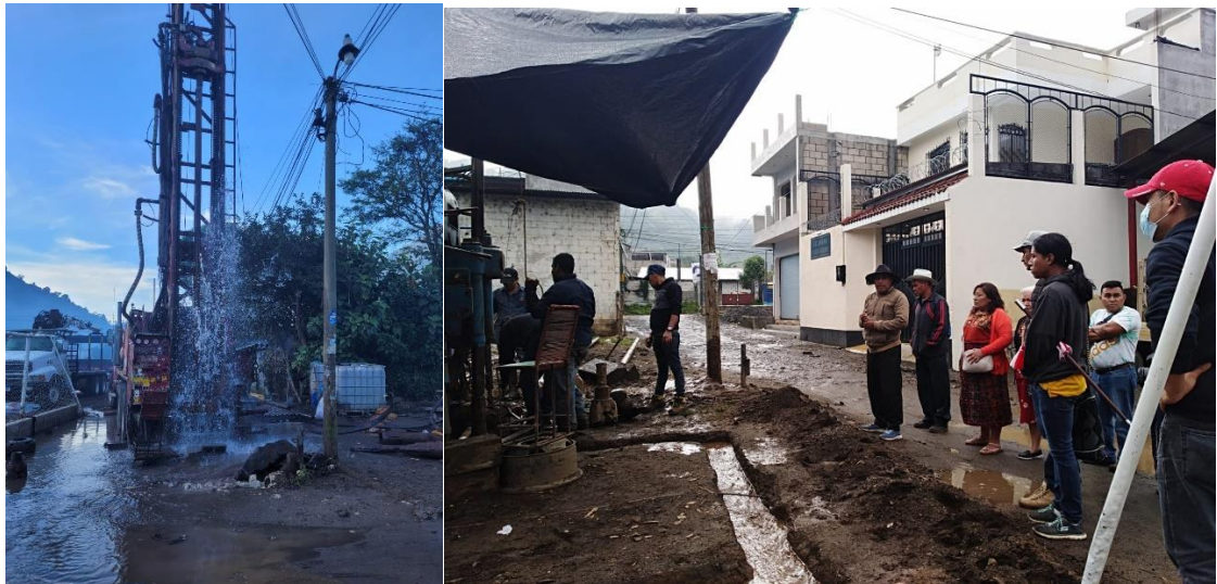
Proyecto: Mejoramiento Sistema de Agua Potable Paraje Pacoc y La Puerta, Cabecera Municipal San Lucas Tolimán, Sololá
